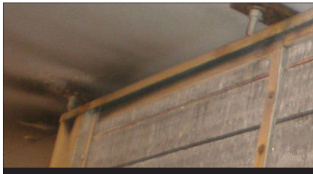
Figure 4 – Bris cause par une période de dégivrage excessif
